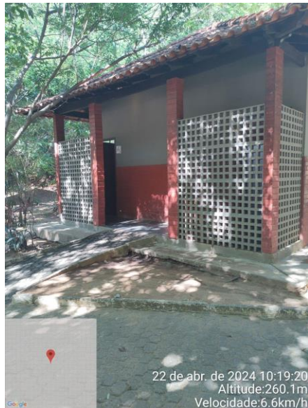
Figura 15. Banheiros localizados a, aproximadamente, 50m do Poço Nilo Peçanha, onde o sumidouro foi instalado ao lado.
