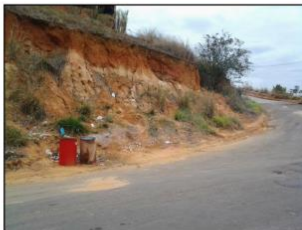
Figura 18. Local com processo erosivo devido ao corte do barranco em Paraíba do Sul. Fonte: Vallenge 2013.
