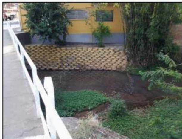
Figura 19. Construção de uma paliçada de pneus feita pelos moradores, na tentativa de evitar a erosão da margem e destruição do imóvel. Fonte: Vallenge 2013
