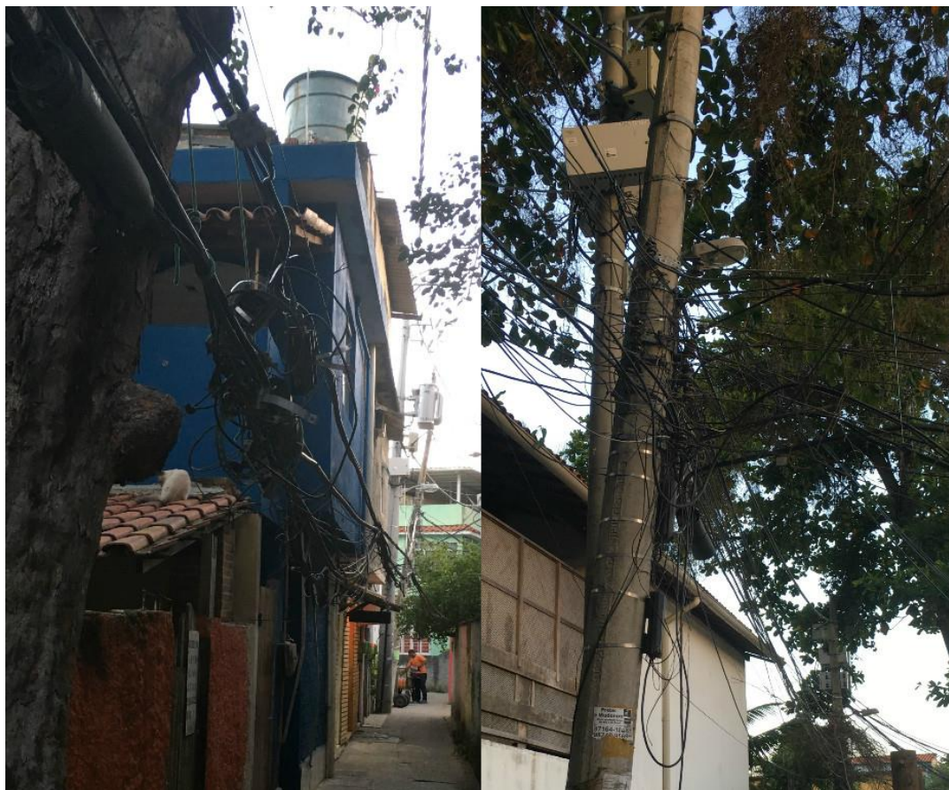
Figura 11. Irregularidades em fios de energia elétrica na Ilha da Gigoia -RJ.
