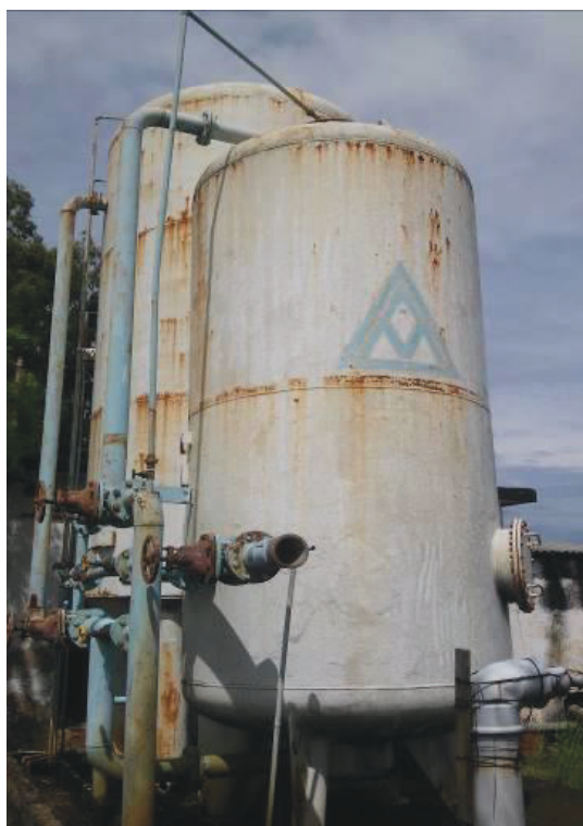
Figura 9. Filtros da Estação de Tratamento de Água, já apresentando condições precárias por conta da ferrugem. Novembro, 2015.
